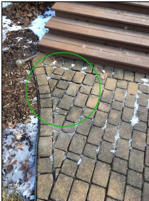
Uneven (trip hazard)
